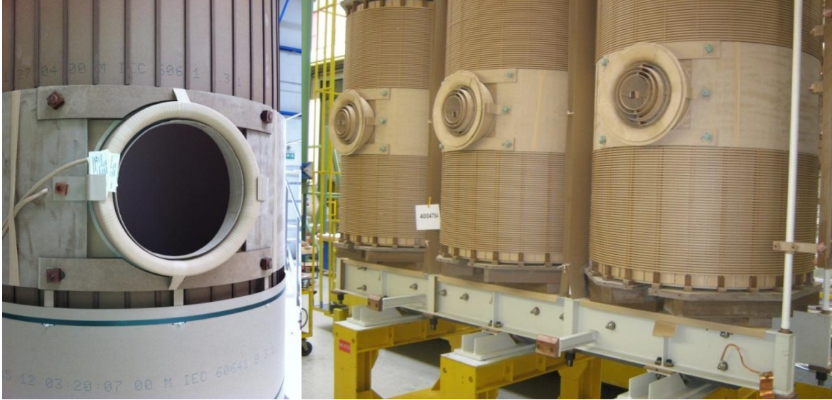
Trafo üzerinde middle exit yerleşimi
