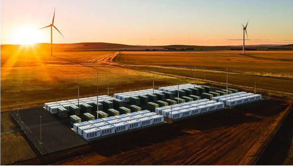
Tesla 100 MW / 129 MWh Enerji Depolama Sistemi, Avustralya.
