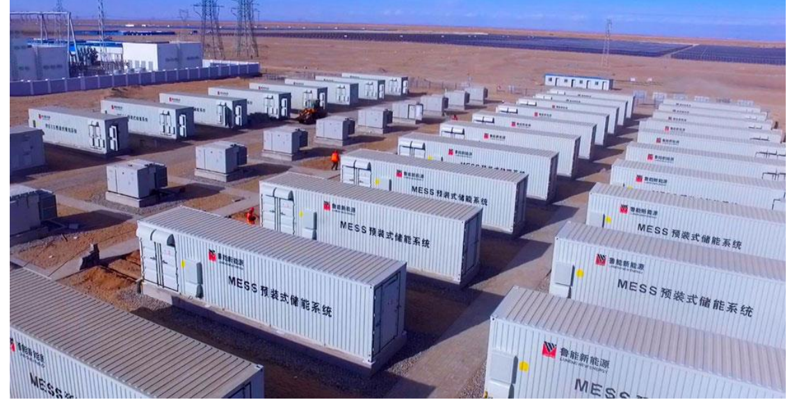
Luneng Haixi Karma Enerji Projesi 400MW rüzgar, 200MW solar ve 100MWh enerji depolama sistemi, Çin.
